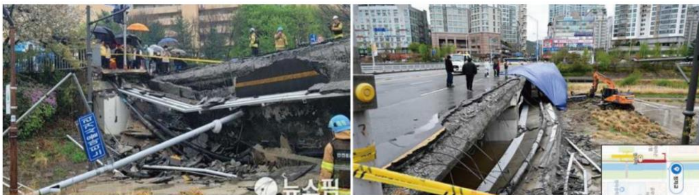
그림 1. 교량 보도부 붕괴 현장
