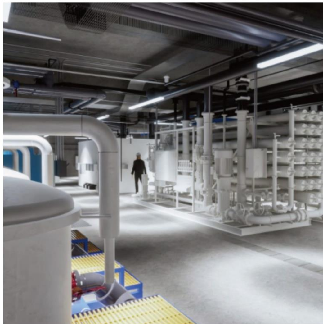
그림 2. SWIP 프로젝트의 수자원 시설 중 AWTF 현장 사진
